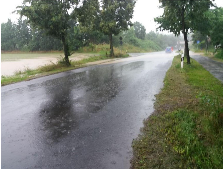
Bild 12 Wasseraustritt mit Erosion vom Feld auf den Uedorfer Weg (Quelle: Stadt Bornheim)
